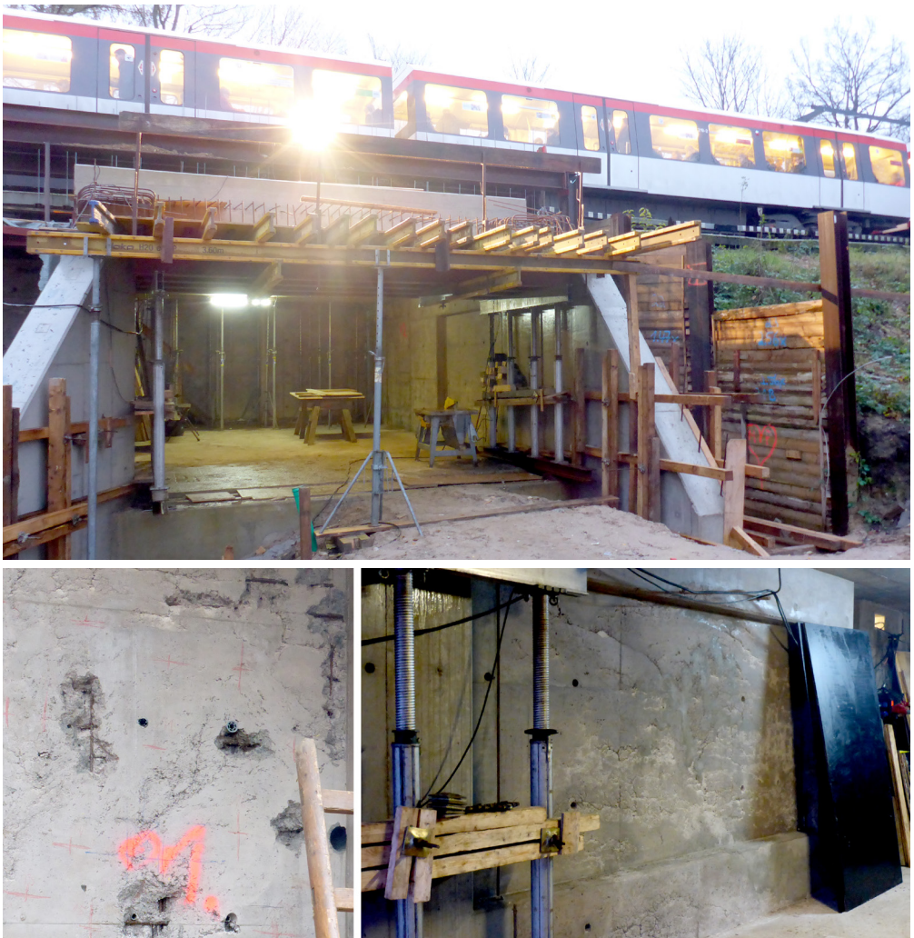
Bild 2: Übersichtsphoto der Baustelle und exemplarische Detailfotos der visuell erkennbaren Schäden
